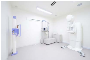
マンモグラフィー一般X線 撮影室
